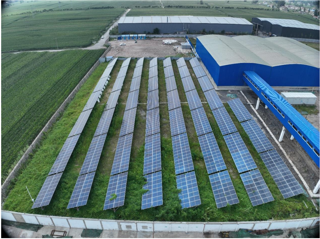
光伏阵列区现状
