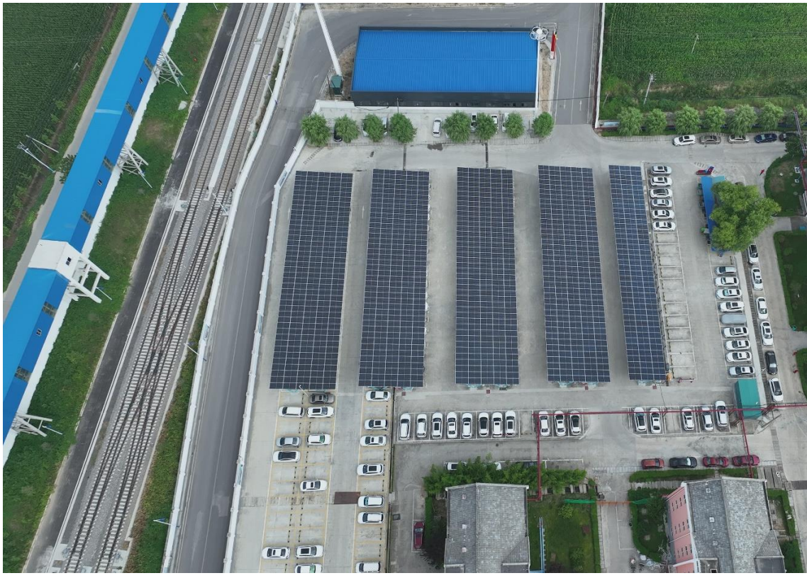
屋顶(停车场车棚)光伏区域
