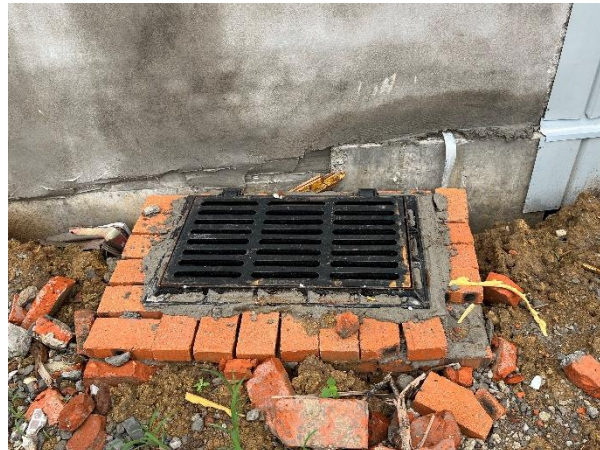
厂区已实施的雨水井
