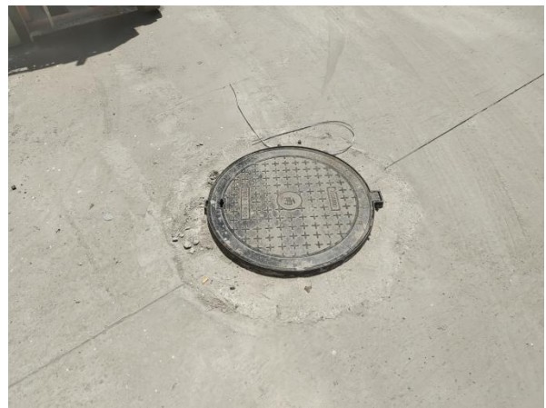
主体工程区已实施的雨水井
