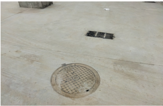
雨水井和雨水口
