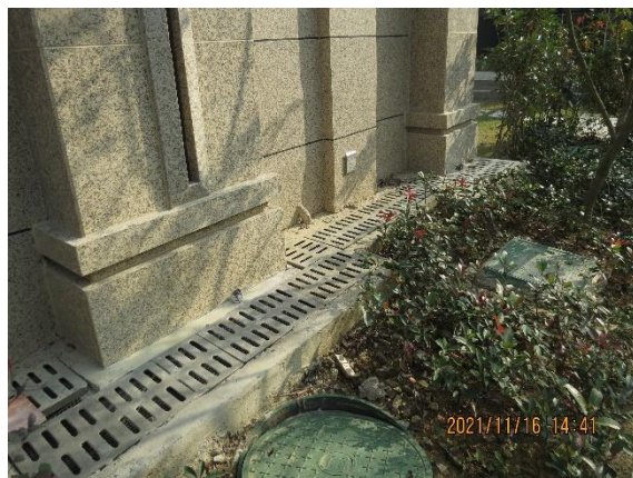
沿建筑物四周布设盖板排水沟
