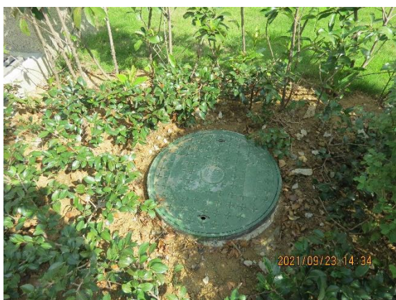
商住楼区雨水井
