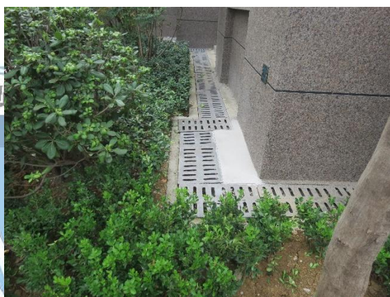
沿建筑物四周布设盖板排水沟
